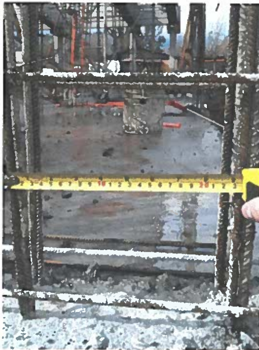
Fotografía 4 Armadura de muro ubicado en eje 1, y entre los ejes A' y B.
